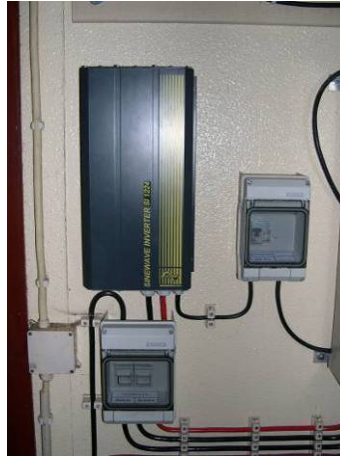
Fig. 5.20 – Inversor do sistema híbrido do INETI, campus do Lumiar ( P_{nom} = 1200 \text{ W} )
