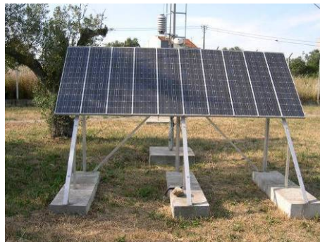
Fig. 5.2- Painel fotovoltaico do sistema híbrido do INETI – 10 módulos Isofotón 55 ML num total de 530 W
