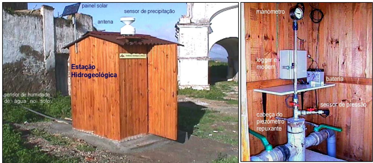
Figura 13.2 – Piezómetro SDTrêsBicas (vistas exterior e interior).
