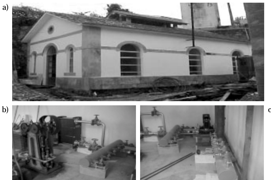
(a) Exterior; (b, c) Interiores com permutador PP1 e colectores.
