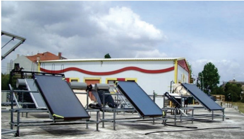
Fig. 3 Plataforma experimental Laboratório de Energia Solar
