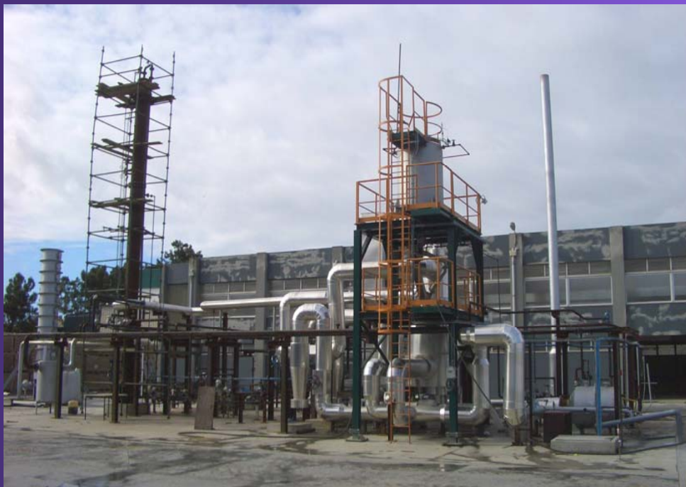
Instalação para pirólise de plásticos
