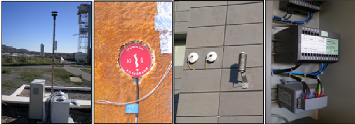
Fig.8.Ejemplo de instalación de sensores para la monitorización
