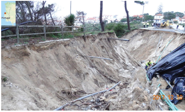
Figura 1. Ravinamento profundo provocado na Rua Aníbal Bettencourt.
