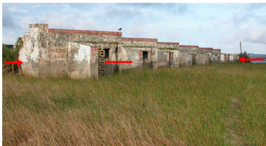
Figura 81. Habitações construídas sobre uma restinga na margem norte da Lagoa do Bilene. Nível de inundação marcado pelas setas a vermelho.
