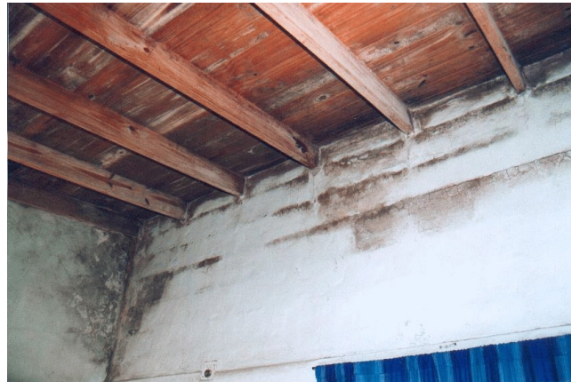
Figura 9: Patologías higrotérmicas en el interior de una vivienda de interés social en Buenos Aires.
