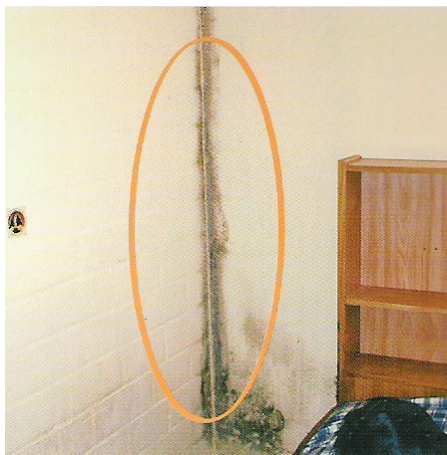
Figura 8: Humedad por condensación
