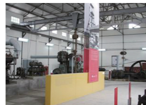
Central de Compressores. (3)
