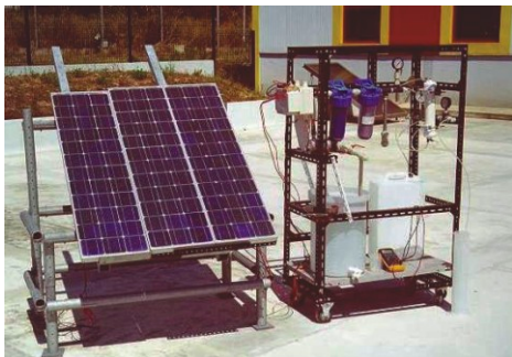
Figura 1 - Purificação de água por osmose inversa com módulos fotovoltaicos
