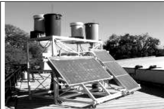
Figura 27: Colectores solares planos en banco de ensayo
