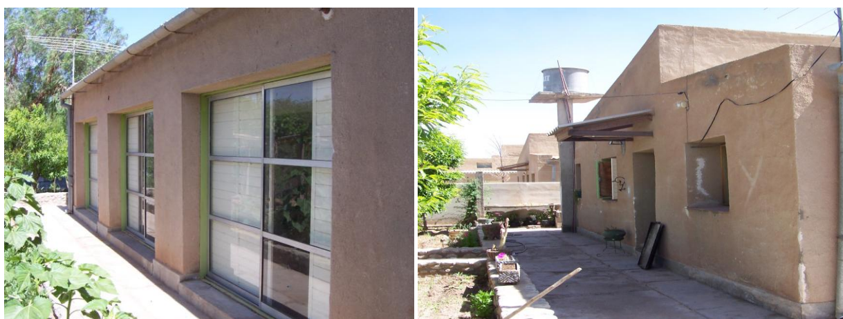
Fig. 9 Viviendas en diferentes estados de conservación
