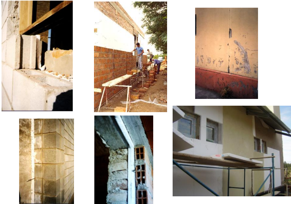
Figura 4: Distintas alternativas para la tapa de la aislación térmica en la envolvente vertical
