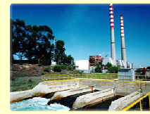
Canal de rejeição de efluente térmico da Central Termoelétrica de Setúbal
