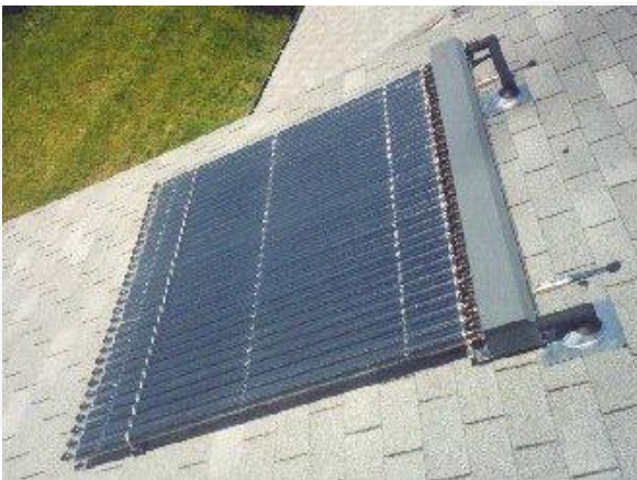
Colector de tubos de vácuo
