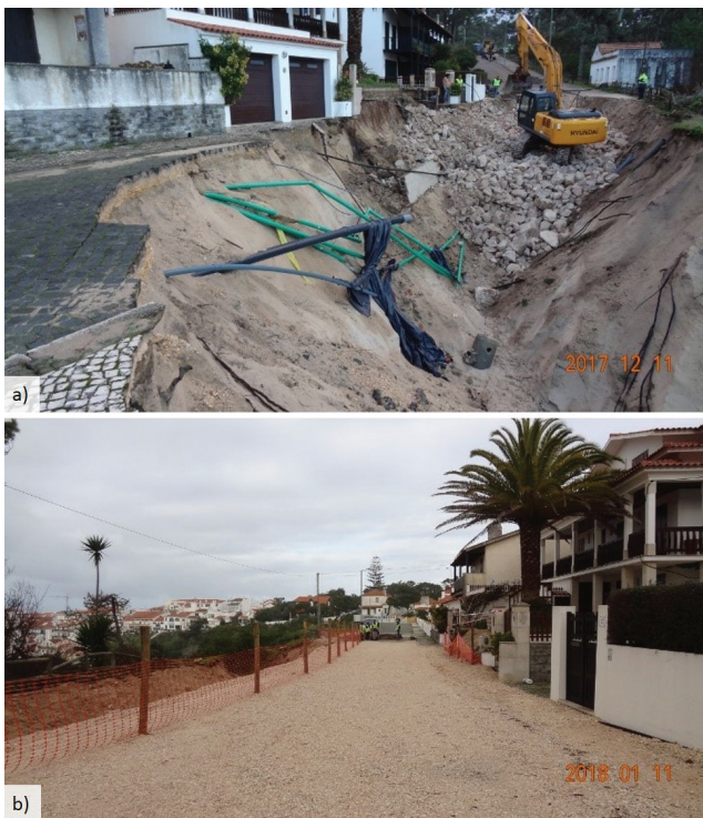
Figura 5. a) Enchimento da zona erodida com rachão; b) reabilitação provisória e proteção com vedação de rede.
