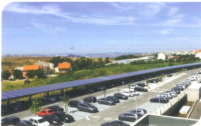
Figura 3 Sistema fotovoltaico de sombreamento do parque de estacionamento dos Edifícios R e S do Campus do Lumiar com 200 kW[3].
