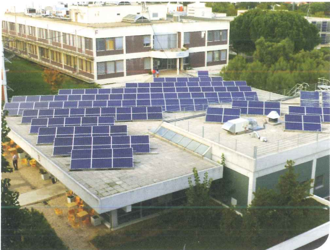
Figura 4 Sistema fotovoltaico da cobertura do refeitório do Campus do Lumiar com aproximadamente 50 kW[3].
