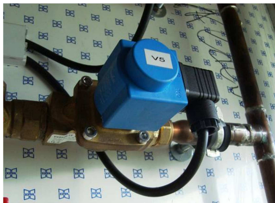
Figura 15 – Válvula electromagnética com activação através de um sinal digital proveniente do sistema de aquisição de dados.
