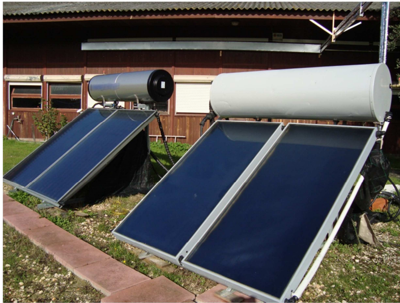
Figura 12 – Sistemas solares térmicos ensaiados no decorrer do projecto. Da direita para a esquerda, sistemas 1 e 2, com depósitos com capacidade para 275 e 200 litros respectivamente.
