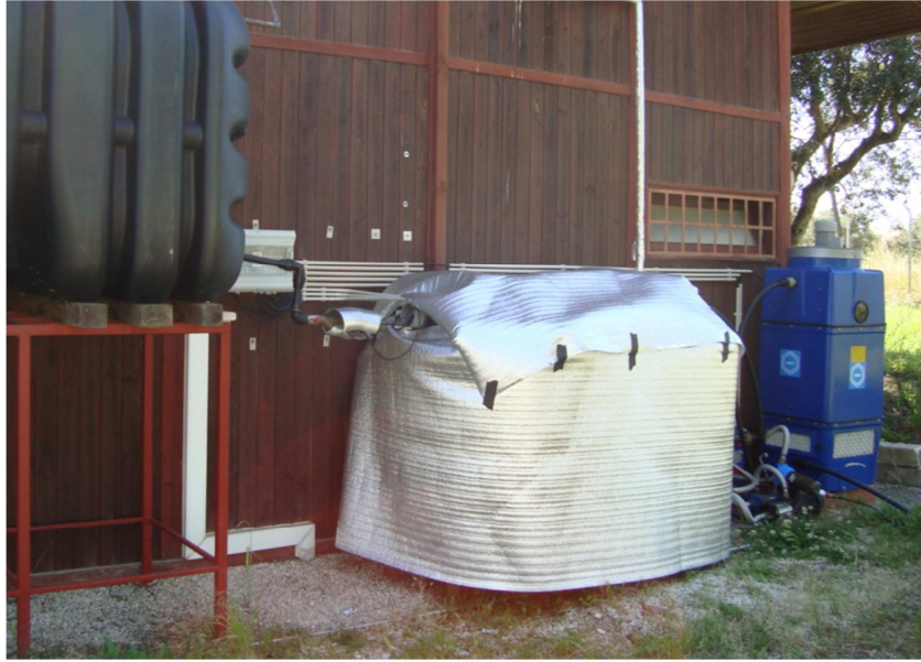
Figura 26 – Depósito de armazenamento 2, isolado com uma capa reflectora, evitando o aquecimento da água devido à exposição à radiação solar.
