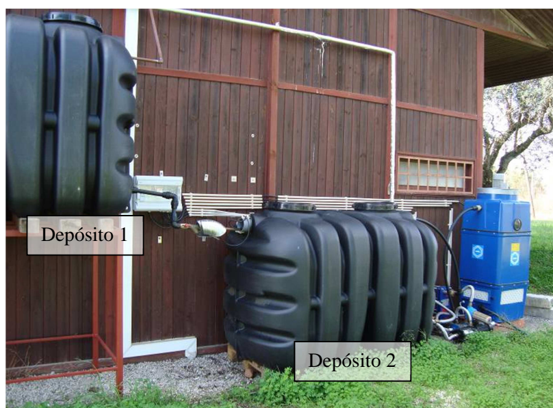
Figura 13 – Localização dos dois depósitos de armazenamento e torre de arrefecimento.
