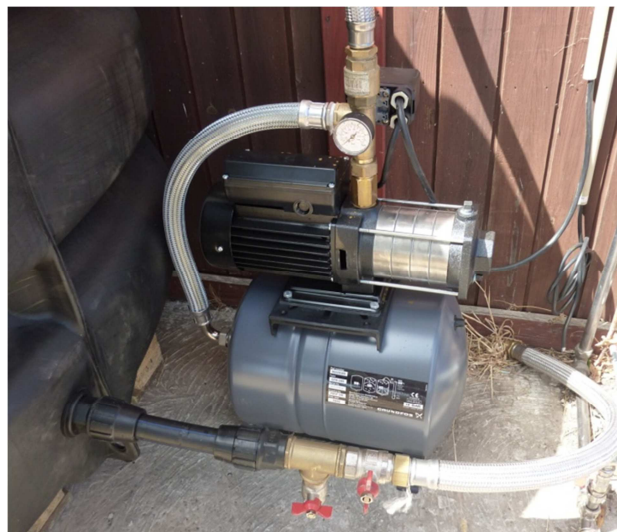
Figura 16 – Bomba B1, utilizada para circular a água contida no depósito 2 para os sistemas solares térmicos.
