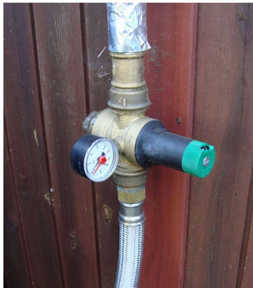
Figura 17 – Válvula redutora de pressão, utilizada para assegurar o correcto funcionamento das válvulas autoflow .
