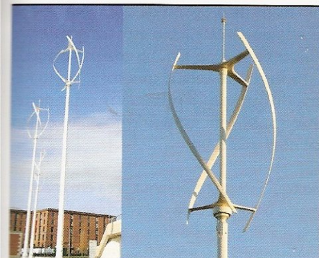
Figura 4 Modelo QR5 - 4.5 kW. Quiet Revolution. Turbina instalada num edifício em Bristol, Reino Unido. (source: www.quietrevolution.co.uk).
