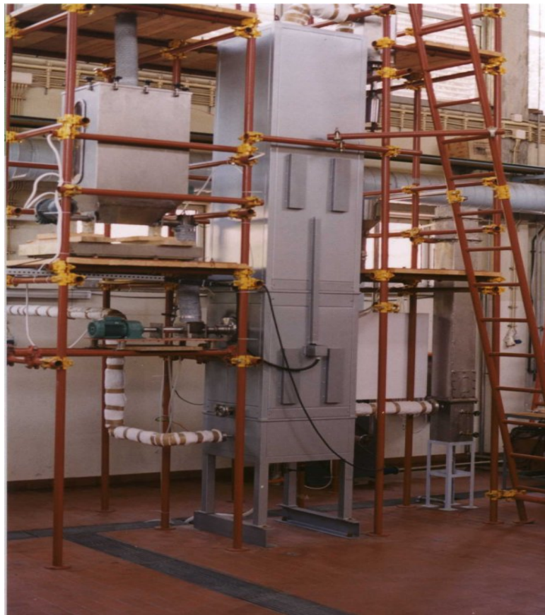
Figura 2.4 – Instalação piloto de gasificação do INETI.
