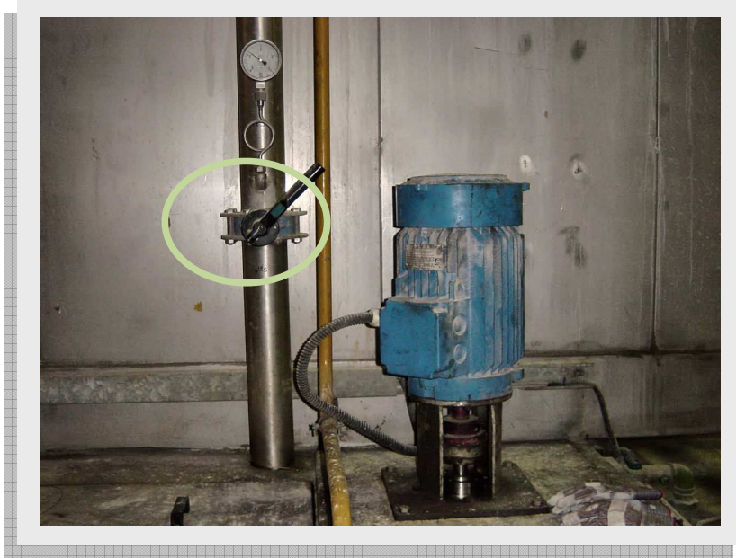
Figura 29 – Regulação de caudais de água por válvula de restrição
