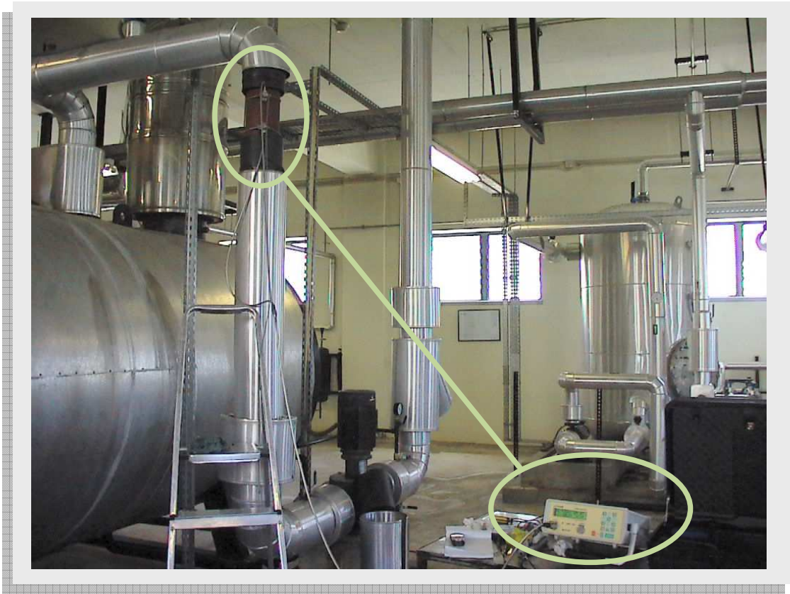
Figura 15 - Medição de caudais de líquidos por caudalímetro ultrassónico
