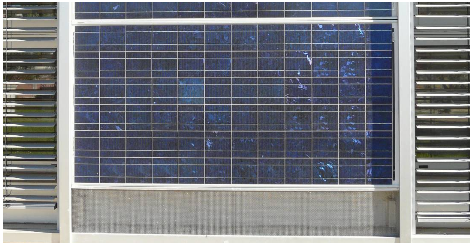
Figura 4.30. Sombras nas células de manhã, provocadas pelos perfis verticais das estruturas que seguram os módulos (01/08/2008 09:00).
