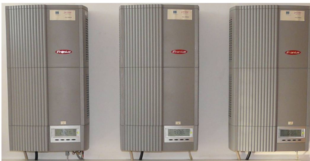
Figura 4.7. Fachada PV- Inversores Fronius IG 40, instalados na Sala 1.06, do Edifício Solar XXI.
