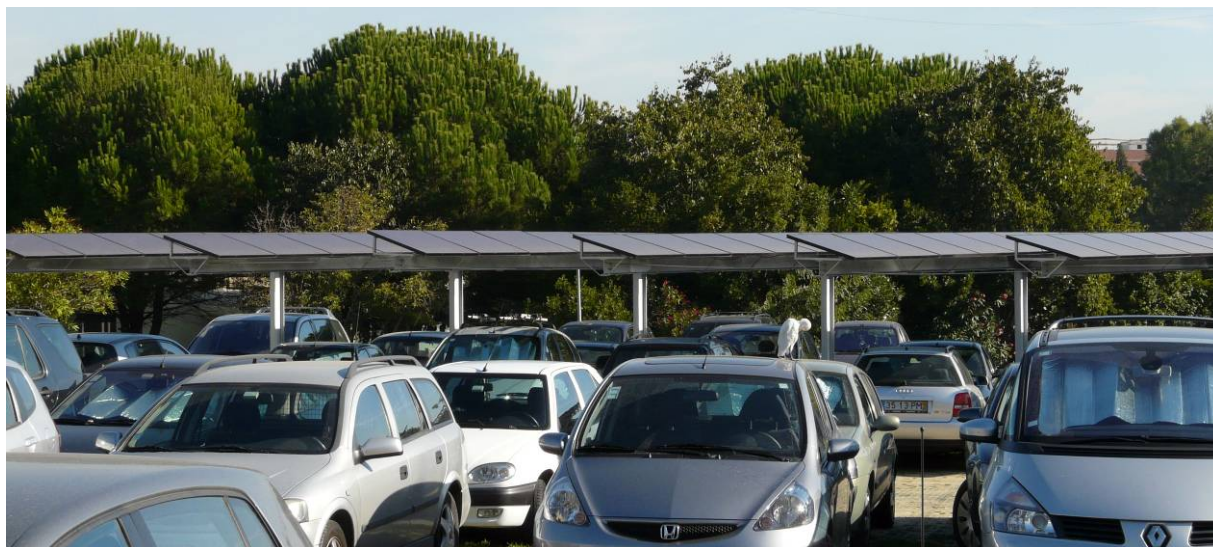
Figura 4.9. Central PV nas estruturas de sombreamento do Parque de estacionamento do Edifício Solar XXI.
