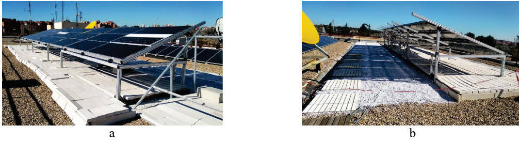
Fig. 1. Generador fotovoltaico bifacial instalado: a) Vista frontal. b) Vista trasera.
